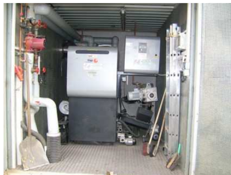
geöffneter Container mit Heizkessel
