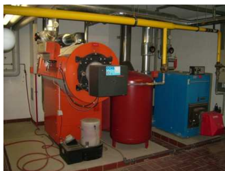
Blick in die Heizzentrale
