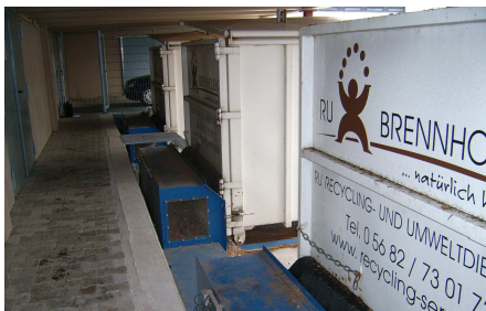
Brennstoffwechselcontainer und -austragung
