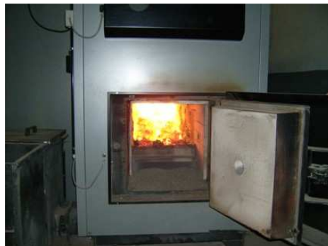
Heizkessel, Blick in Feuerraum
