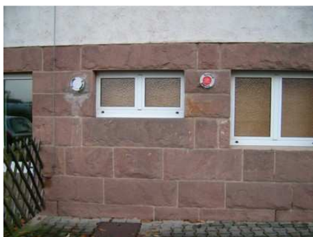
Anschlusstutzen zum Befüllen
